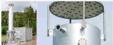
Degazificarea depozitului sanitar
